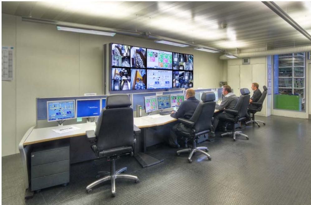
Bild 7: Leitwarte in einem Presswerk der Automobilindustrie
