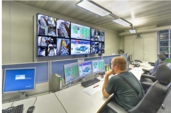
Neue Leitwarte im Presswerk in Bremen
