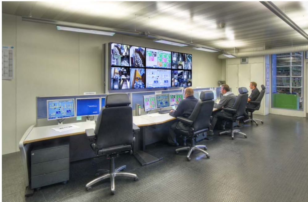
Bild 7: Leitwarte in einem Presswerk der Automobilindustrie
